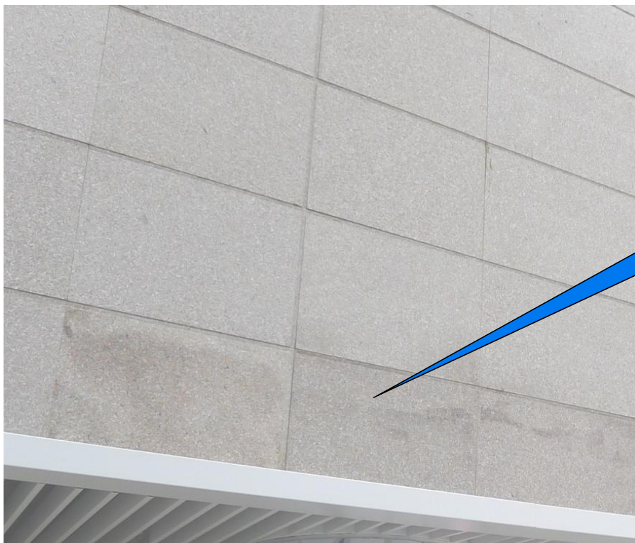
墙柱面石材污染
