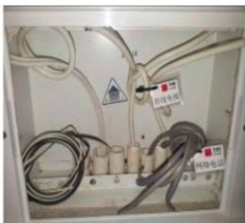
弱电箱体内布线标识
